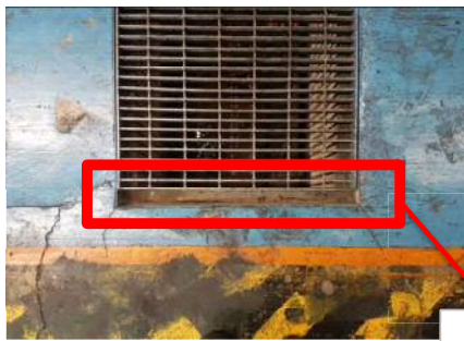
写真1. 安全通路上の側溝グレーチング
